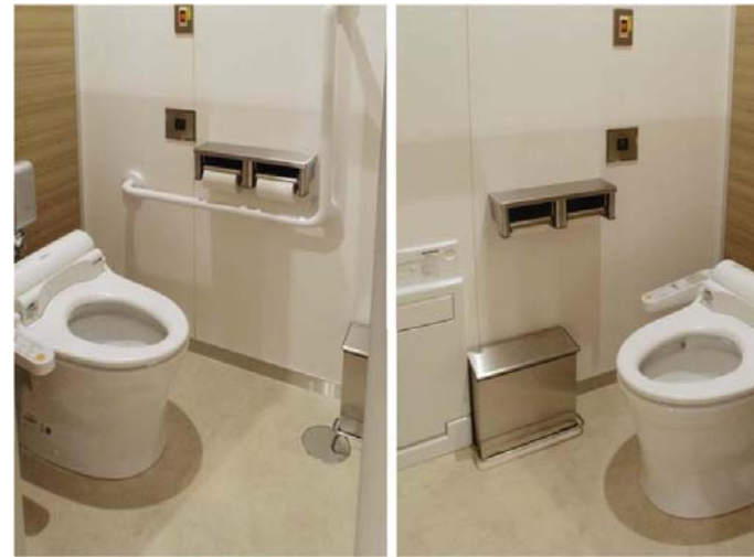
事前の学生アンケートで、最も要望が多かった大便器の洋式化を実現し、すべての大便器にウォッシュレットを設置。環境に配慮して、5.5L洗浄のパブリックコンパクト便器を採用している。
