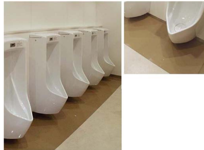
床の清掃性や節水性に優れた壁掛式の自動洗浄小便器を採用。小便器の足元には、尿の飛散によるにおいや汚れを軽減するハイドロテクトイルを設置している。
