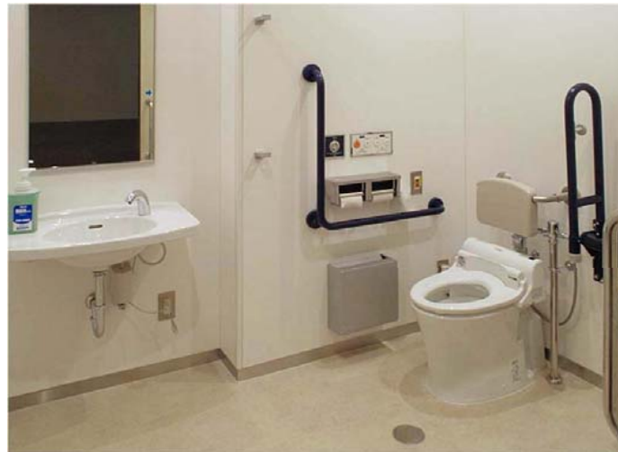
車いすから大便器に移乗しやすいように、L型手すりとはね上げ手すりを設置。座位の安定をサポートする背もたれも完備している。
