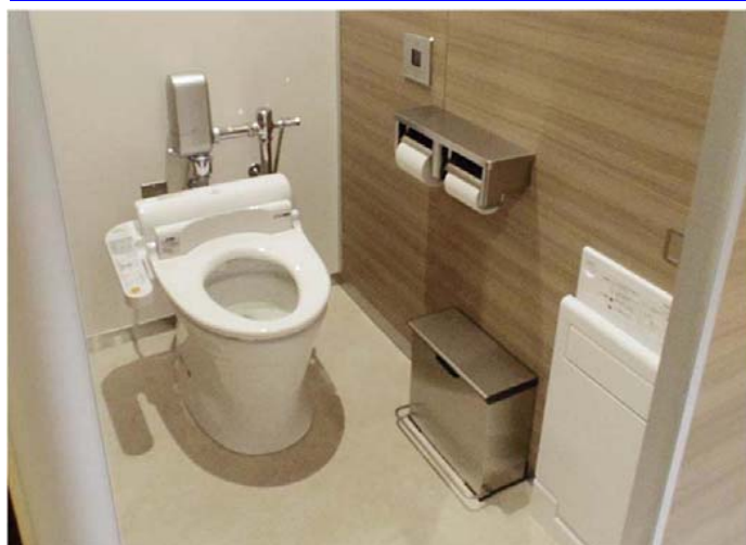
衛生面に配慮して大便器はセンサー式洗浄タイプを採用し、汚物入れもベダル式を設置。大便器ブースの2ヶ所には、着替えができるフィッティングボードを完備している。
